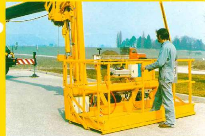
Die betriebsbereite Arbeitsbühne kann vom Boden aus bestiegen werden.
